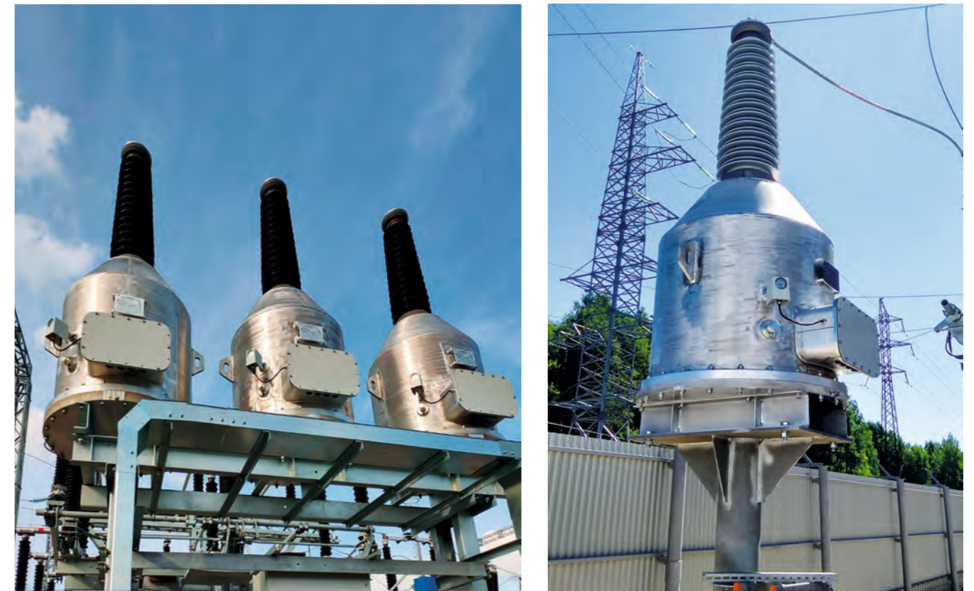
Рис. 2. ТНБМ ЗНГ-УЭТМ®-110 (63) на ПС Коврово и ПС Союз
